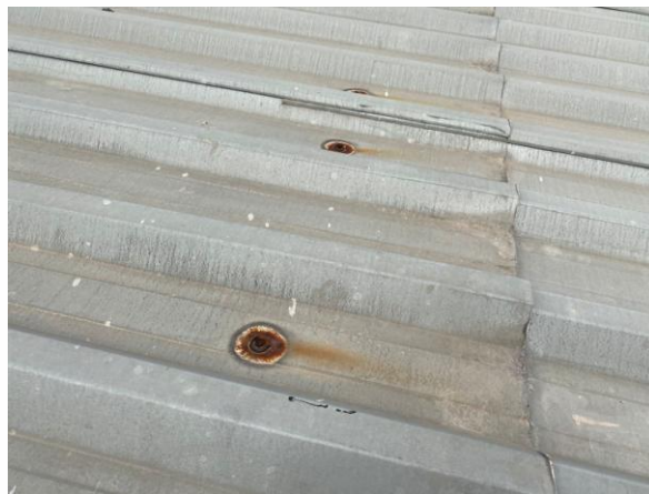
Figura 3- Corrosão galvânica nos parafusos.
