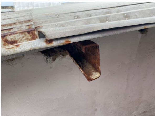
Figura 4- Terça em elevado grau de corrosão.
