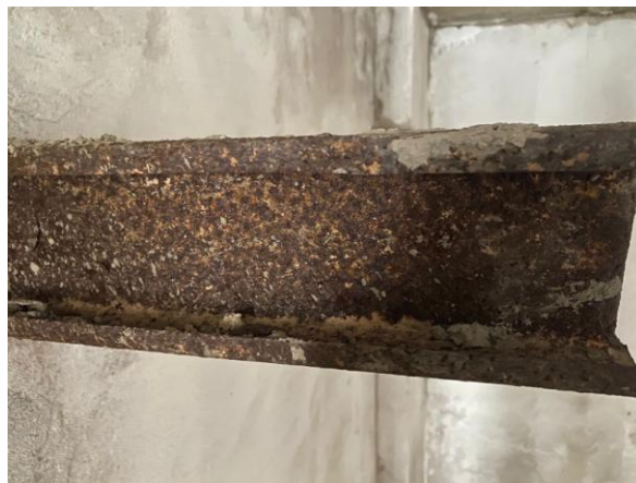
Figura 5- Detalhe da corrosão da terça em outro ponto do telhado.
