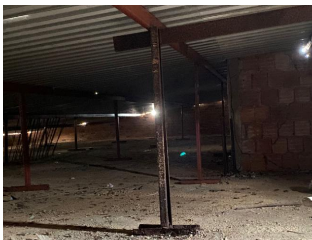
Figura 6- Pilaretes em perfil U enrijecido com elevado grau de corrosão.
