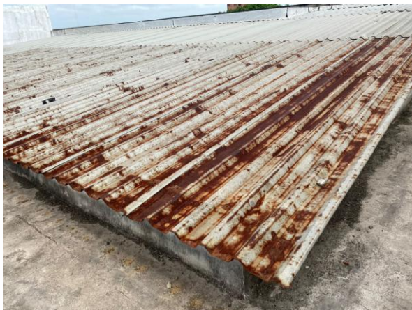
Figura 2- Telha metálica com elevado grau de corrosão.
