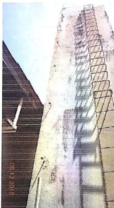
FOTO 35 – FOTO DO CASTELO D'ÁGUA – RECOMENDA-SE A INSTALAÇÃO DE SISTEMA DE PROTEÇÃO TIPO CAPTOR DE FRANKLIN EM PONTOS MAIS ALTOS DA EDIFICAÇÃO
