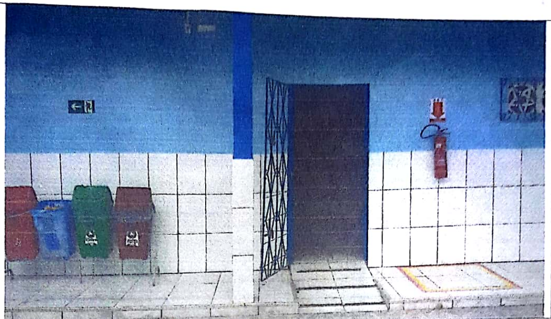
Foto 04: Demonstra instalação do Extintor, Placa de Sinalização e Luminária de Emergência
