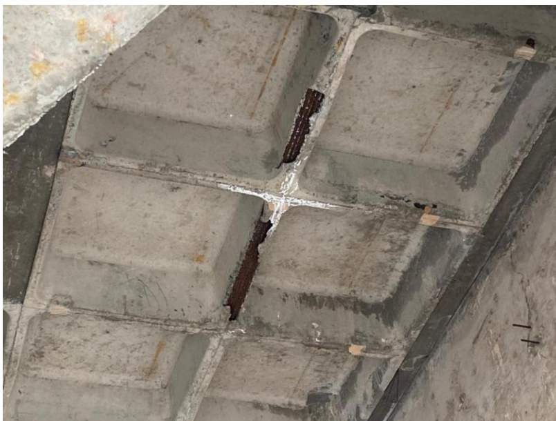
Figura 1- Ferragem exposta na laje nervurada.
