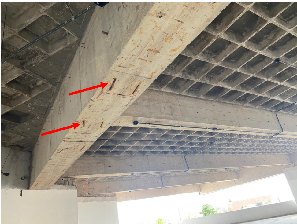
Figura 4- Oxidação do aço na face inferior da viga.
