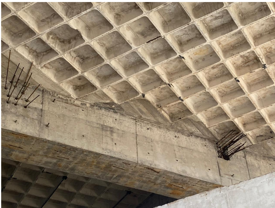
Figura 5- Cordoalhas de aço expostas em processo de corrosão.
